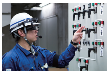
管制室からの指示を仰ぎながら変電室の制御盤を確認
