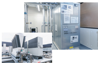
屋上設置の地中熱利用空調システムの水冷式ヒートポンプユニット。3方式の効率運用でピーク電力を抑制。
