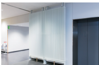
市庁舎内の1階・2階に設置された熱交換を利用した輻射熱パネル。
