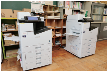
印刷室にあった印刷機を撤去して そこに2台のLX-10050MFを並べて配置
