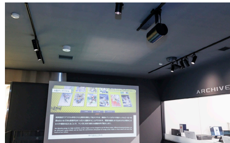
“マンガの蔵展示室”天井部に設置されたEV-110を使い大型スクリーンで動画を上映、来場者への案内を行っている
