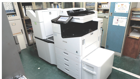
職員室隣の印刷室にLX-10050K+フィニッシャー+大容量給紙ユニット×1台を設置
