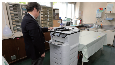
職員室の作業テーブル近くに増設カセット3段装着のPX-M7110F×1台を設置
